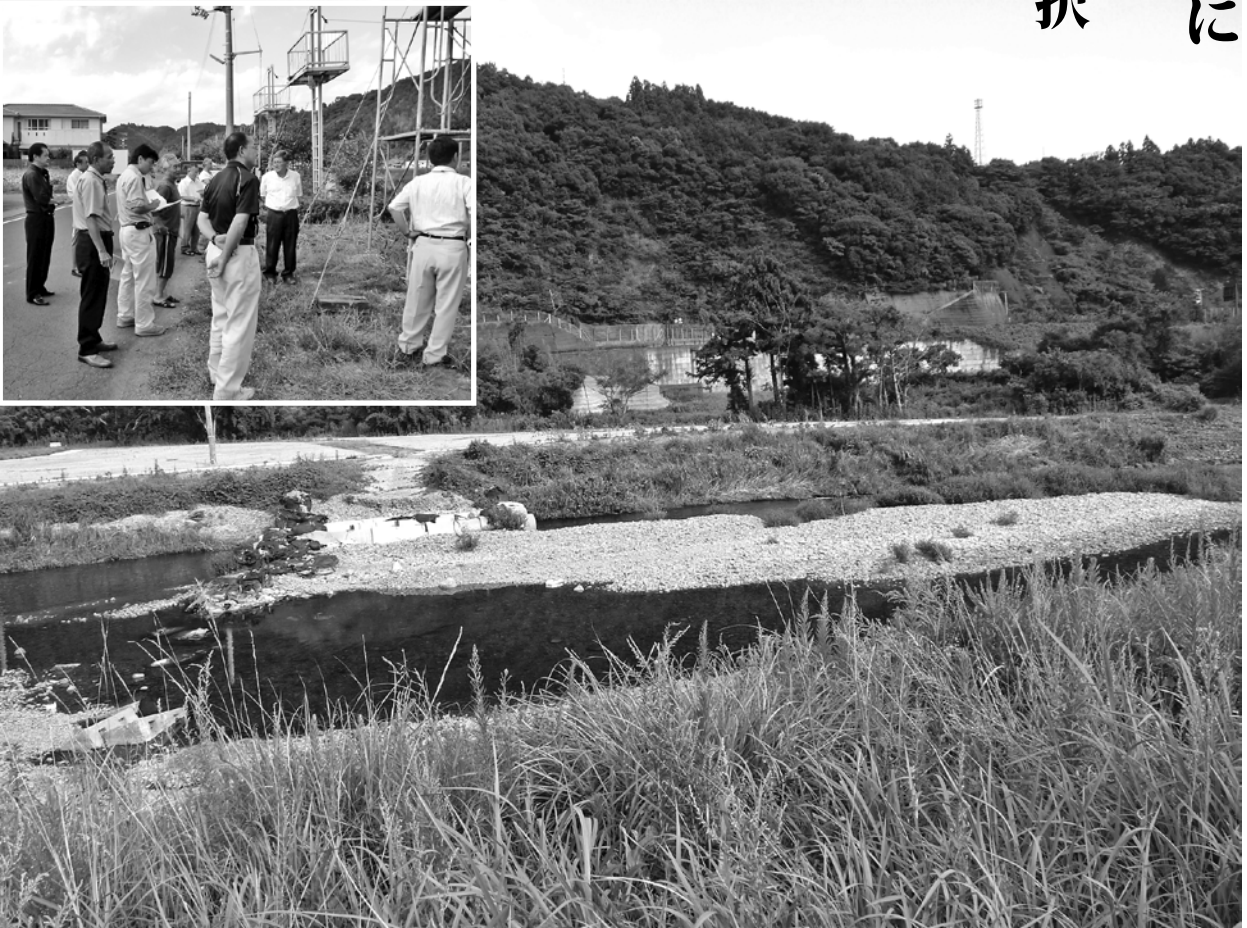
土砂に埋もれた飛石工部分
